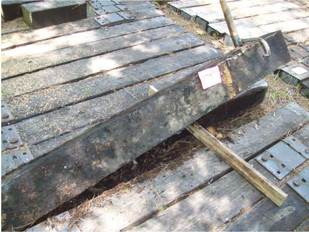
Figure 567 - Tie #279 (Koppers/red oak/P2 creosote).
